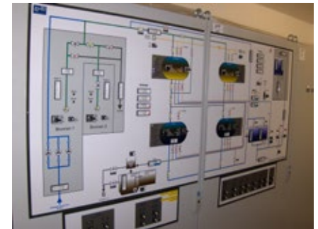
Neue Mess-, Steuer- und Regeltechnik im Hochbehälter Kappelberg
